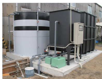
廃水処理設備
